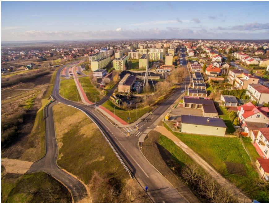
Zdjęcie 2. Budowa ulicy łączącej ul. Kazimierza Wielkiego z ul. Ks. Kardynała St. Wyszyńskiego w Busku-Zdroju – etap II
