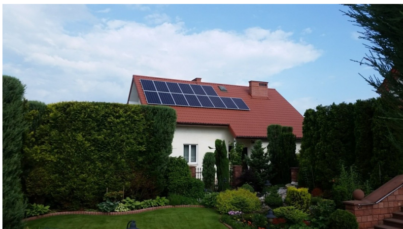
Zdjęcie 9. Instalacja fotowoltaiczna na budynku mieszkalnym
